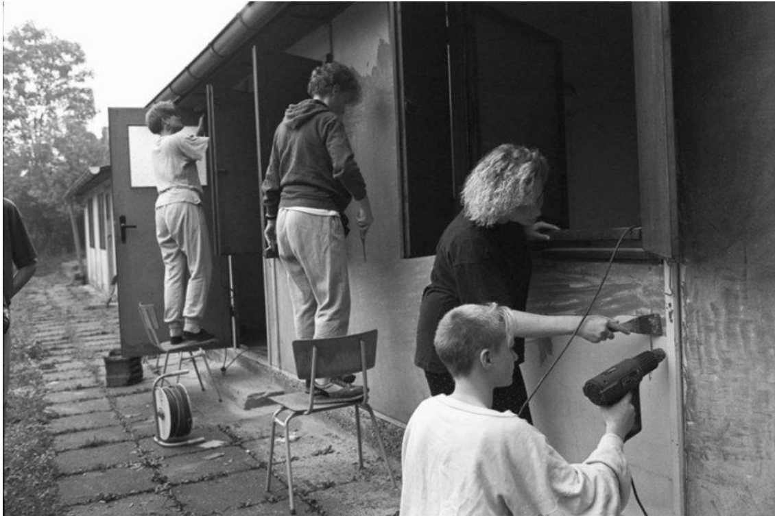
Jugendliche bei AgAG-finanzierten Umbauarbeiten der früheren Station junger Naturforscher im thüringischen Arnstadt zu einem Jugendtreff 1992
